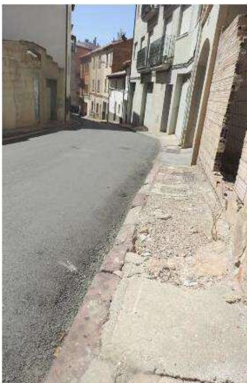
Aceras en mal estado en la calle La Alforja del Arrabal
